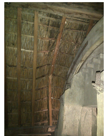
Schade aan de kap
